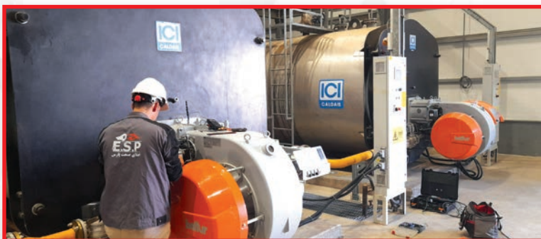
ICI Boiler & Baltur Burner
